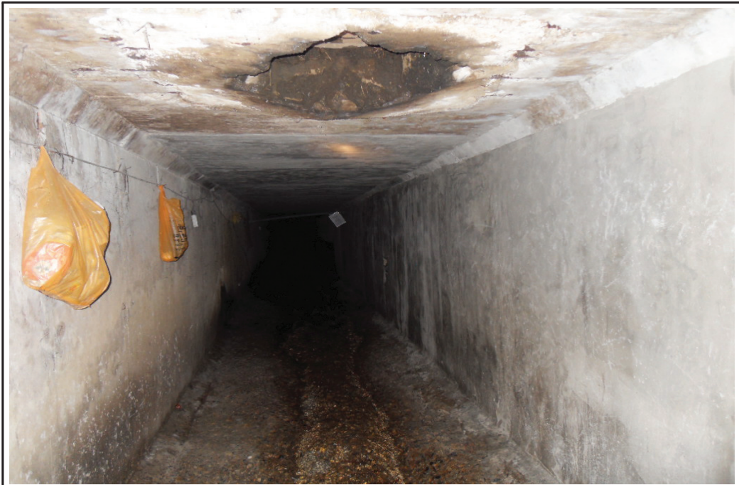
재해발생 현장전경(맨홀아래 지하 우수박스 내부)
